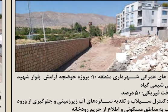
پروژه های عمرانی شهرداری منطقه ۱۰: پروژه حوضچه آرامش بلوار شهید مردانی شیمی گیاه پیشرفت فیزیکی: ۵۰ درصد هدف: کنترل سیلاب و تغذیه سفره‌های آب زیرزمینی و جلوگیری از ورود سیلاب به مناطق مسکونی و اطلاع از حریم رودخانه
