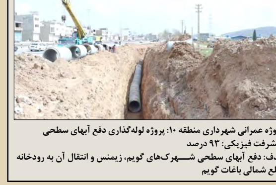
پروژه عمرانی شهرداری منطقه ۱۰: پروژه لوله‌گذاری دفع آبهای سطحی پیشرفت فیزیکی: ۹۲ درصد هدف: دفع آبهای سطحی شهرک‌های گویم، زمینس و انتقال آن به رودخانه ضلع شمالی باغات گویم
