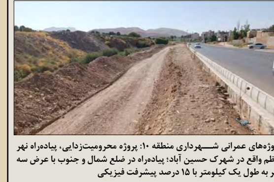
پروژه‌های عمرانی شهرداری منطقه ۱۰: پروژه محرومیت‌زدایی، پیاده‌راه نهر اعظم واقع در شهرک حسین آباد؛ پیاده‌راه در ضلع شمال و جنوب با عرض سه متر به طول یک کیلومتر با ۱۵ درصد پیشرفت فیزیکی
